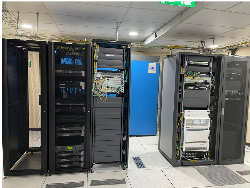
Figura 2: Estado actual del equipamiento en el CPD
